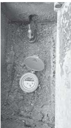
町内住宅に設置されている水道メーター
