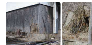
ハチの巣を狙って壊された建物
