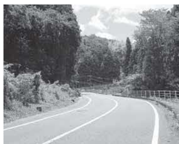
将来的な法面对策が望まれる
