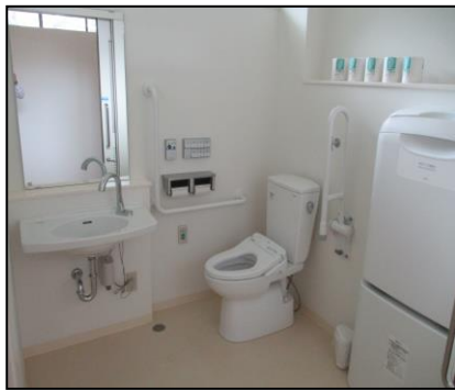
多機能トイレの設置
