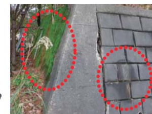
水がしみだしている擁壁 （提供：社団法人 全国宅地擁壁技術協会）
