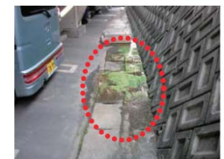
湧水部分にコケが生えている擁壁 （提供：社団法人 全国宅地擁壁技術協会）
