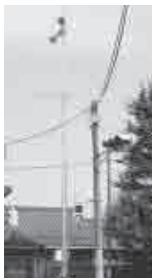
防災行政無線 三井化学（株）装束門
